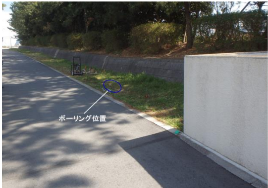
図 2 ボーリング地点付近の土手の状況。地表の変形は修復され平らとなっているが、土手は地震後の沈下したままである。ボーリングはこの土手の脇で行った。
